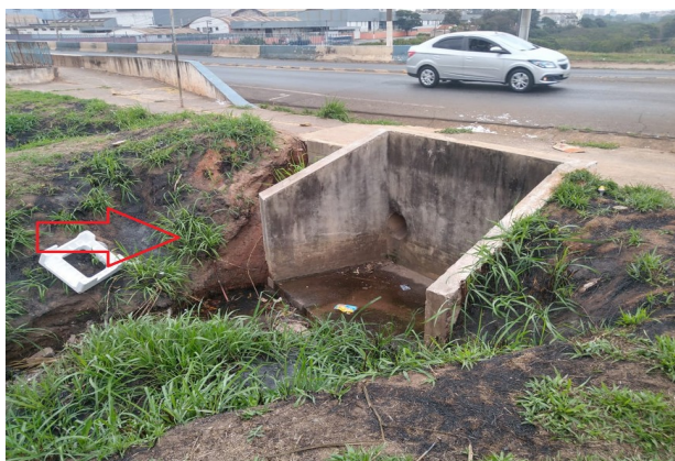
Muro ALA com erosão eixo 5
